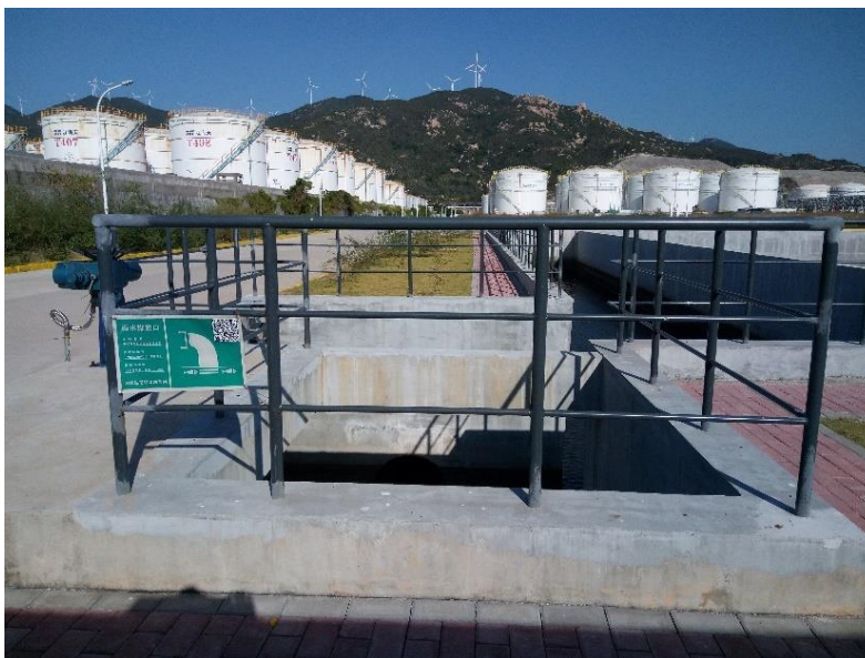
南迳湾库区雨水总阀
