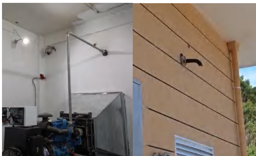
图 7.3.3-2 莲花山分输站备用柴油发电机及其排气口
