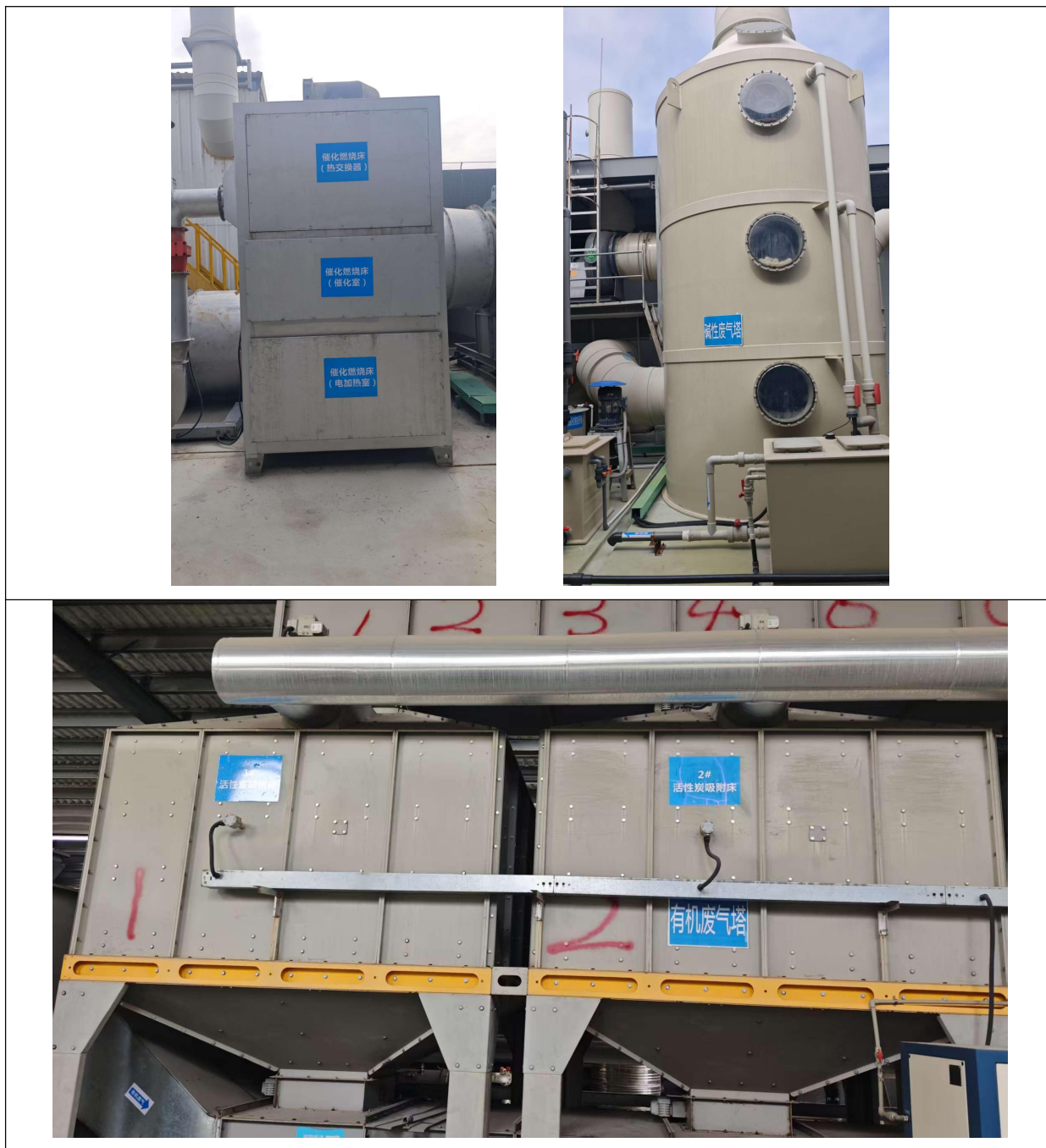
图 4.1.2-1 项目废气处理设施
