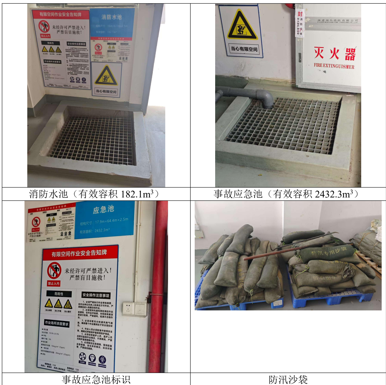
图 4.2.1-1 项目事故应急池及应急物资
