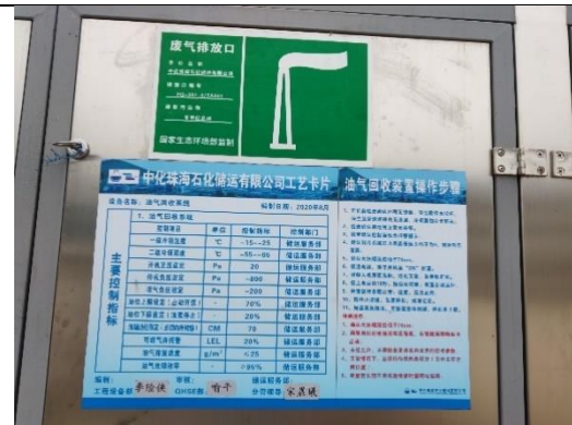
1#油气回收装置(铁炉湾库区)
