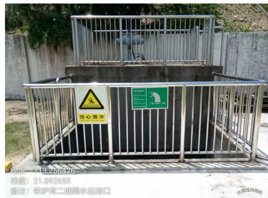
铁炉湾二期雨水总阀
